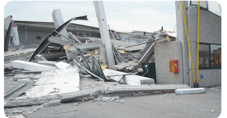
Struttura prefabbricata lesionata a seguito di un sisma avvenuto nel 2012 in Emilia-Romagna
