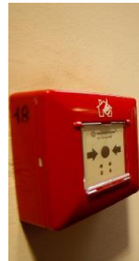
Un allarme antincendio
