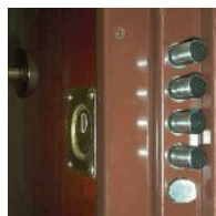
Serratura di una porta blindata
