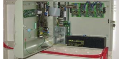
Un quadro elettrico
